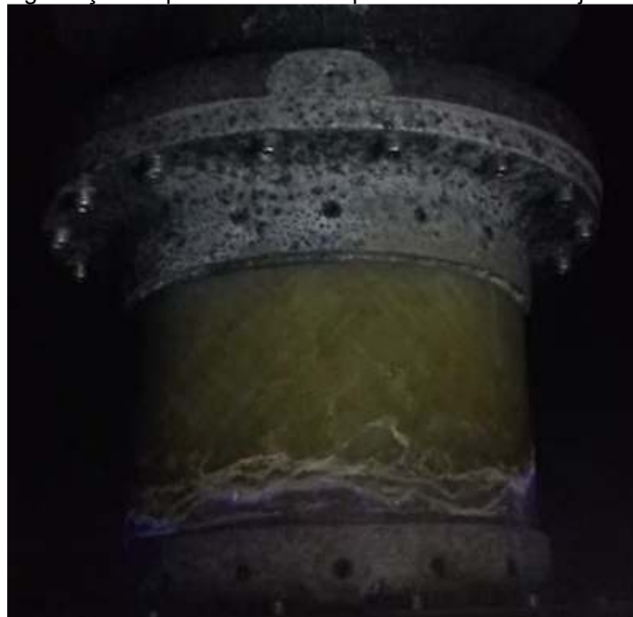
Figura 5.22 – Degradação da parte isolante do pólo da fase B do disjuntor VCDJ2-12.
