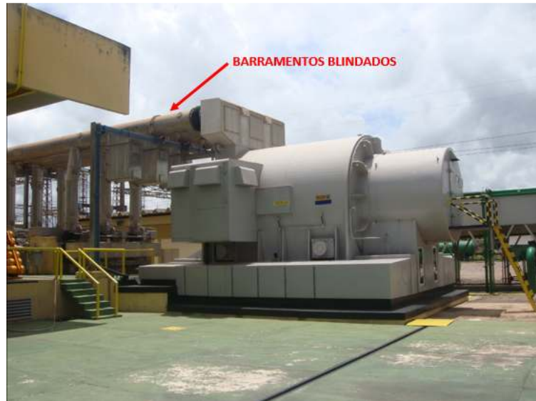
Figura 5.2 – Barramentos blindados do compensador síncrono 2 da subestação Vila do Conde da Eletrobras Eletronorte.
