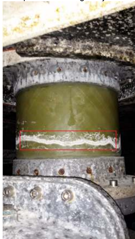
Figura 5.8 – Pólo sobressalente instalado na fase B do disjuntor VCDJ2-12 com isolamento em processo de degradação.
