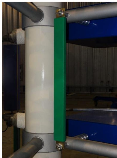
Figura 31 – Resistores de potencial do Gerador de Impulsos do LEAT
