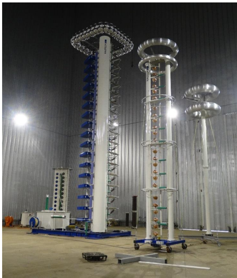
Figura 27 – Sistema Gerador de impulsos de Tensão 18 estágios, 3600kV, 540 kJ do LEAT
