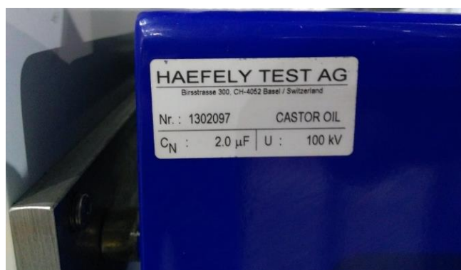
Figura 5.18 - Dados de placa do capacitor de carregamento.
