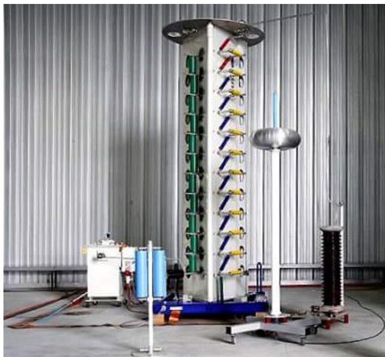
Figura 4.4 - Gerador de Impulsos de Corrente do LEAT.
