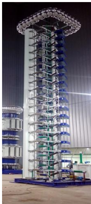
Figura 14 – Gerador de impulsos de tensão do LEAT-UFPA.
