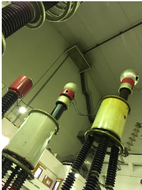
Figura 19 – Transformadores em cascata do IEE-USP.
