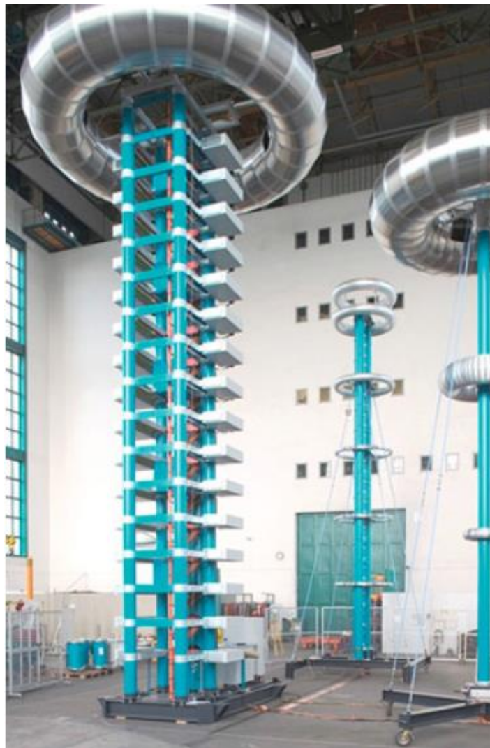
Figura 3 – Gerador de Impulso de Tensão 3.2 MV, 320 kJ. Fabricante: HIGHVOLT Pruftechnik Dresden GmbH
